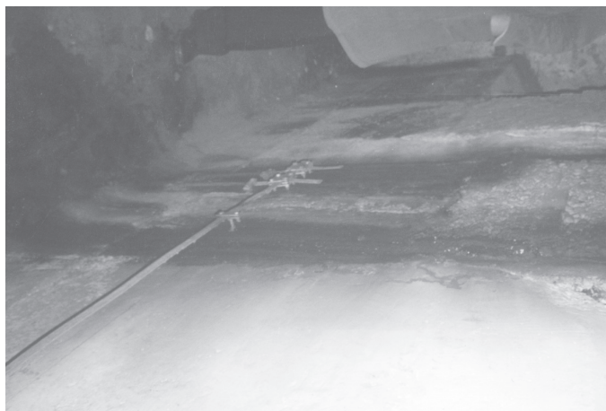
Slika 1. Propuštanje i kondenzacija na vanjskoj stijeni dimnjaka
